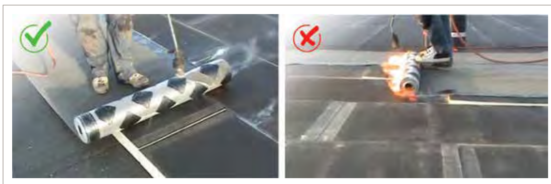
Afbeelding 31 en 32: Aanbrengen van waterdichting met brander op Eurothane Bi-4-platen (Links: Branden op de waterdichtingsrol (gedeeltelijk hechtend membraan); rechts: branden op isolatieplaat)
